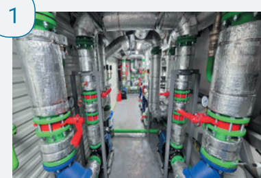
1. Модульные котельные блочного исполнения
