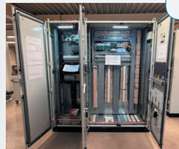
7. Шкафы питания и коммутации, шкафы управления
