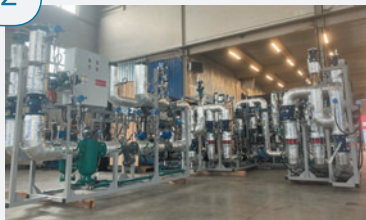
2. Автоматизированные тепловые пункты
