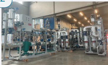
2. Автоматизированные тепловые пункты
