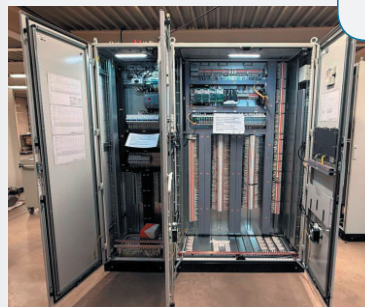
7. Шкафы питания и коммутации, шкафы управления
